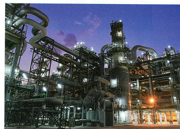
カタールで手掛けたLNGプラント。同国では新規大型案件も受注している
